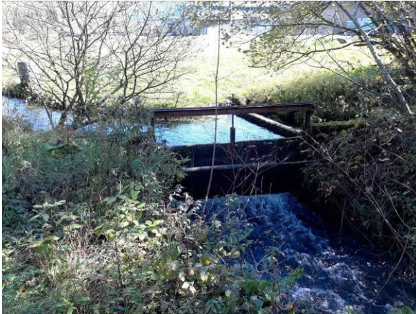
Schieber bei Gütsch
